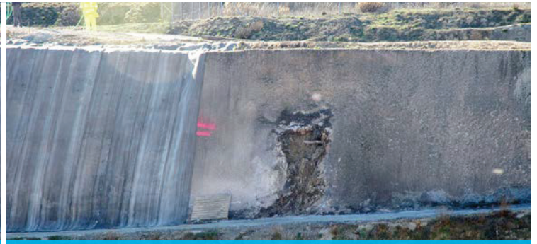
Разрушенный торкретированный участок
